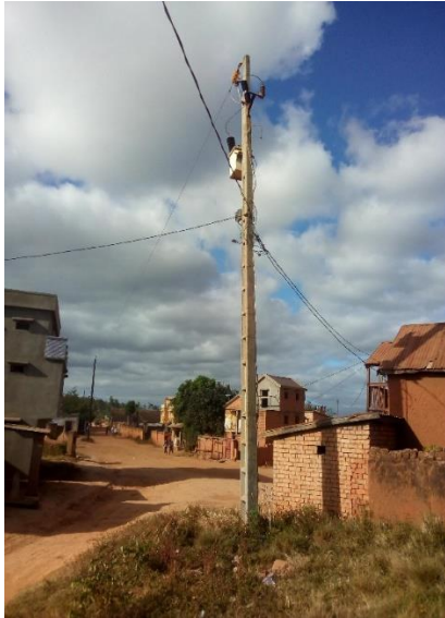
Transformateur et ligne à remplacer
