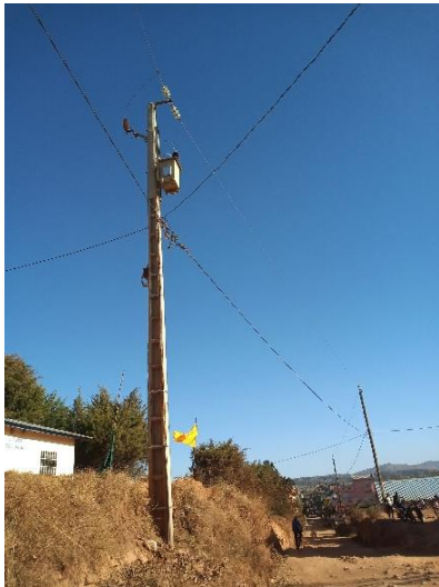
Transformateur à remplacer
