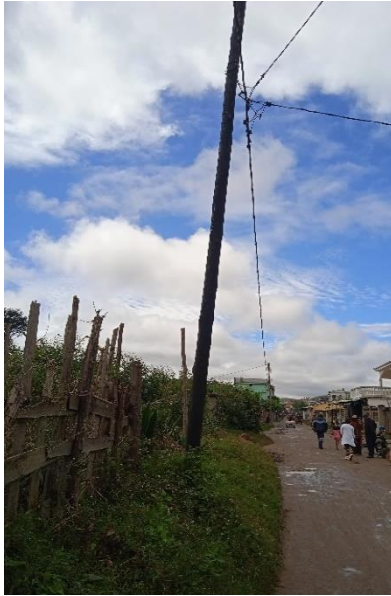
Exemple câbles BT et poteau en bois à remplacer à Moramanga
