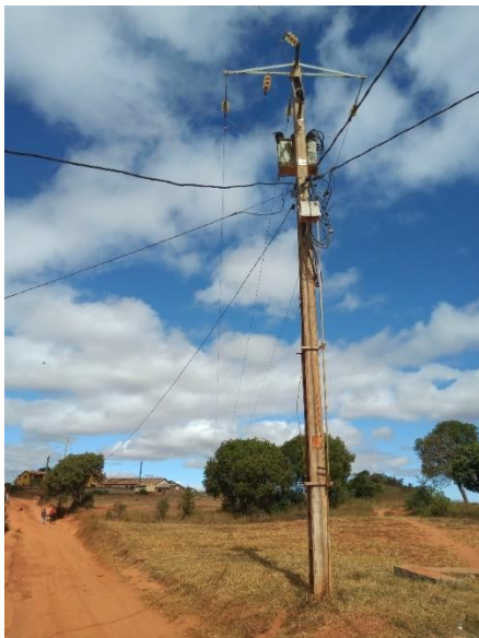
Poste 1278 à soulager
