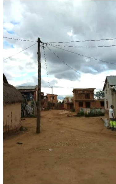
Exemple câbles BT et poteau en bois à remplacer à Soavinandriana
