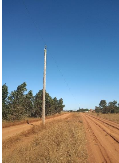
Exemple câbles et poteaux à remplacer
