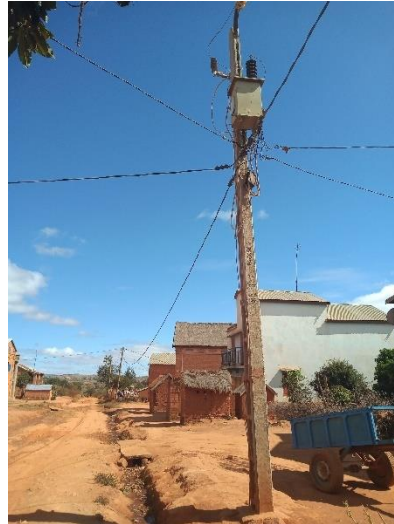
Exemple de transformateur et ligne à remplacer à Ambohitrambo
