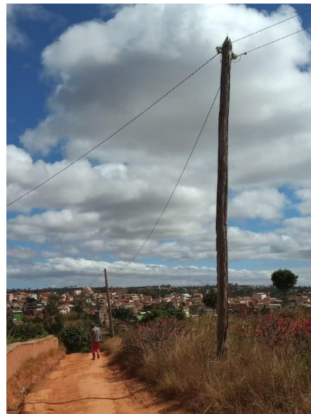
Exemple câbles à renforcer et poteau en bois à remplacer
