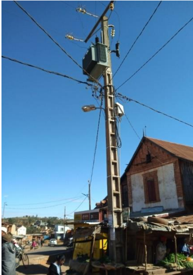
Transformateur à déposer
